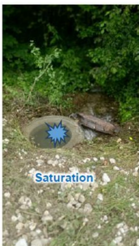
Photo 47 : Saturation du regard d'évacuation des eaux pluviales le long de la RD520A (route de Chartreuse) (photo RTM, 10/06/2024)
