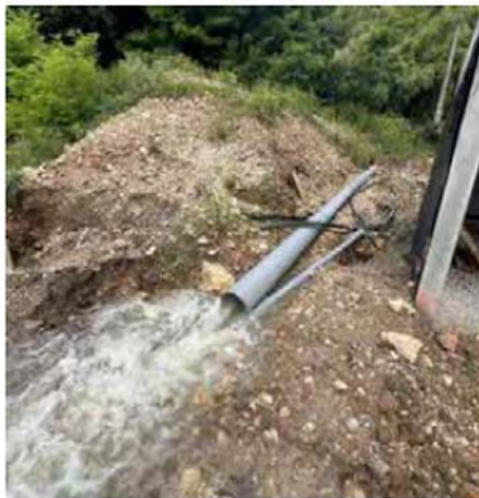
Photo 43 : Restitution des écoulements captés une 10aine de mètres en amont (photo RTM, 10/06/2024)
