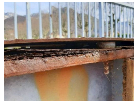
Photo n° 16 : Corrosion avec feuillette des semelles supérieures des poutres
