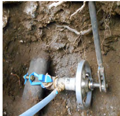
Machine à prise en charge sur le réseau
